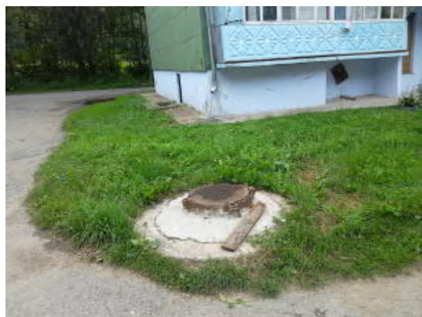
Люки подземных коммуникаций жилого дома по ул. Молодежная, д.4, 17.07.2021, 09:39
