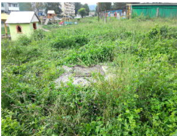
Люк подземных коммуникаций жилого дома ул. Молодежная, д.5, 17.07.2021, 09:44
