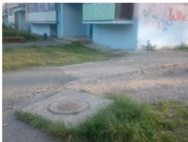
Люк подземных коммуникаций ул. Дымова, 1, 19.07.2021, 13:43
