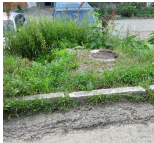
Люк подземных коммуникаций жилого дома ул. Молодежная, д.8, 17.07.2021, 10:40
