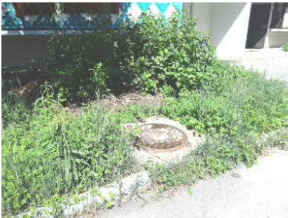
Люк подземных коммуникаций жилого дома, ул. Набережная, 2а, 18.07.2021, 14:27
