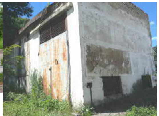
Трансформаторная подстанция жилого дома ул. Набережная, 6, 17.07.2021г. 12:33
