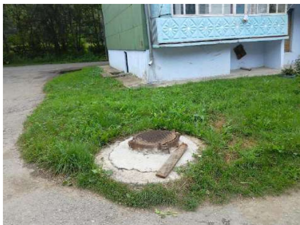
Люки подземных коммуникаций жилого дома по ул. Молодежная, д.4, 13.07.2023, 09:39
