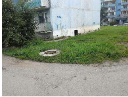
Люки подземных коммуникаций жилого дома ул. Молодежная, д. 7, 13.07.2023, 10:23
